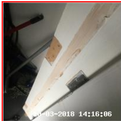
1.4.2 RHS Door Frame Trim Missing
